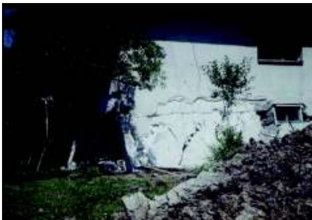
Središnji dio klizišta (jedan od uništenih objekata)
